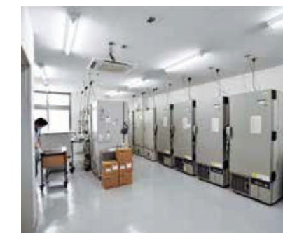
超低温冷凍庫(-80℃)専用室。計32台に3万点の新鮮凍結脳を収納し、デジタルデータベース管理しています。
